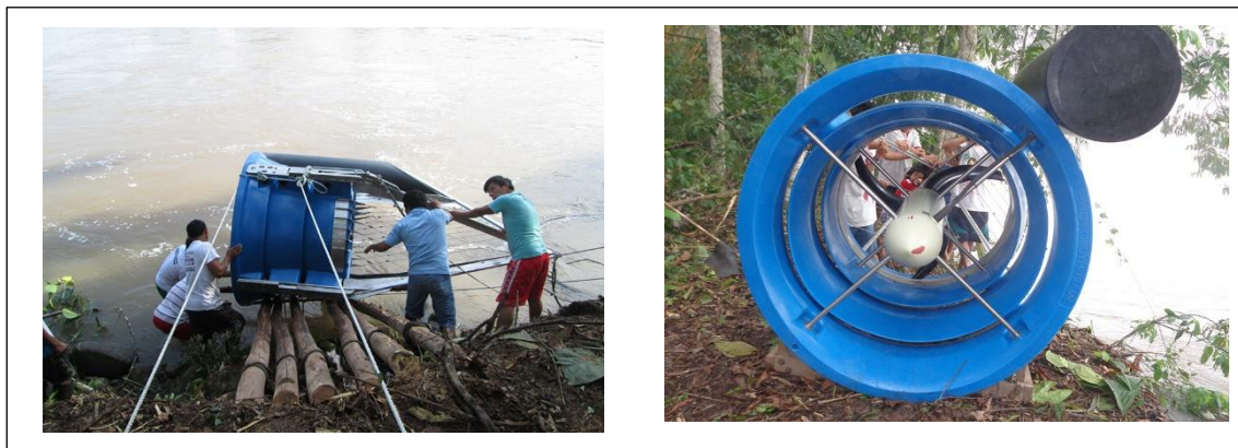
Figura 7 - Instalação de uma turbina hidrocínética em Marisol, Peru. Fonte: Smart Hydro, 2025.
